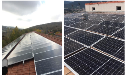
Resim 10. Çatı Üstü Fotovoltaik Güneş Enerji Sistemi (PV)
